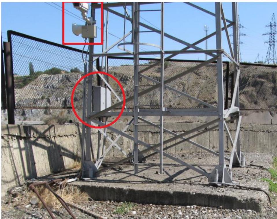
Электрооборудование систем охраны (камеры, датчики движения)
