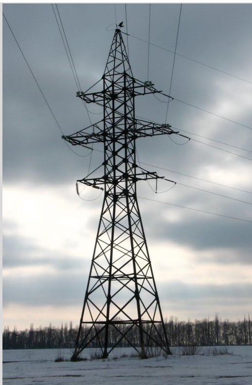
ВЛ 110 кВ – 250 тыс. км, провода АС, опоры 22 м и более, трос
