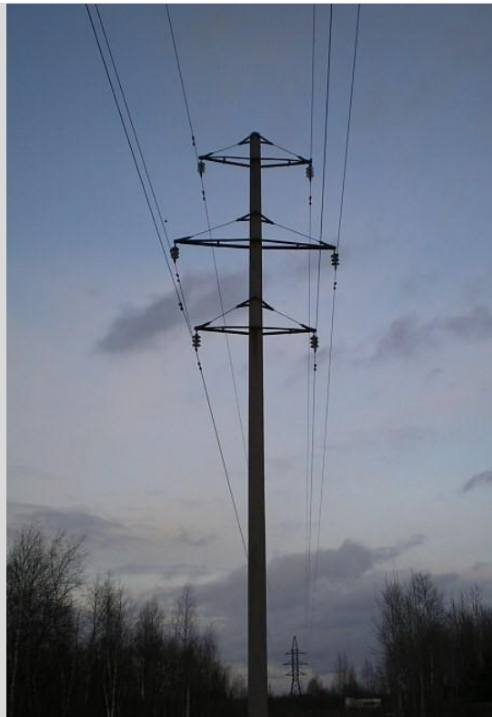
ВЛ 35 кВ – 200 тыс. км., провода АС, опоры до 20 м, без троса
