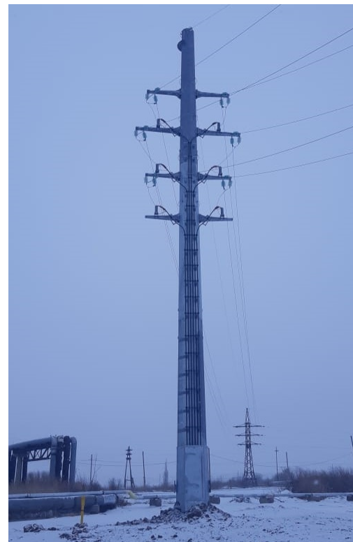
ПКПО-КВ-35.1-2.1, п. Ясный, Оренбургская область
