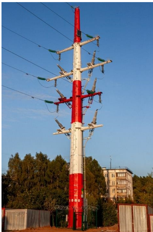
ПКПО-КВ-110.1-2.1, Мытищи, Московская область
