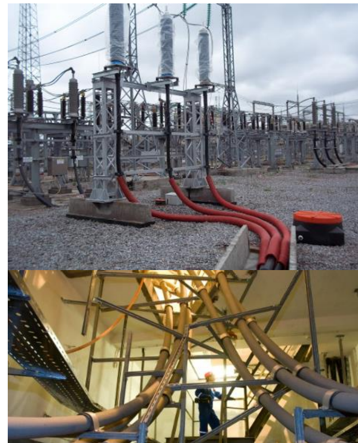
Кабельные заходы на подстанции
