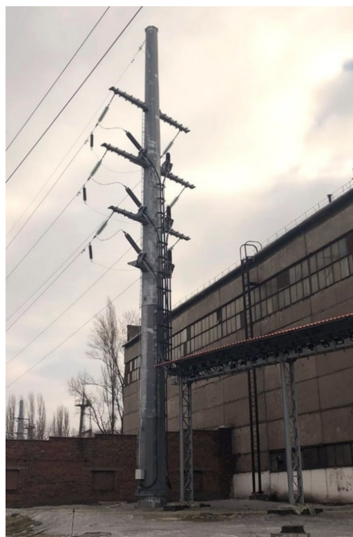
ПКПО-КВ-110.1-2.1, Губкин, Белгородская область
