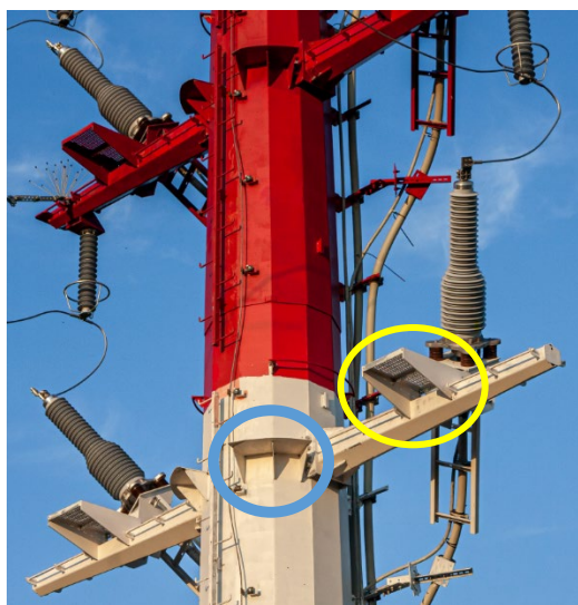
Площадки для обслуживания муфт
