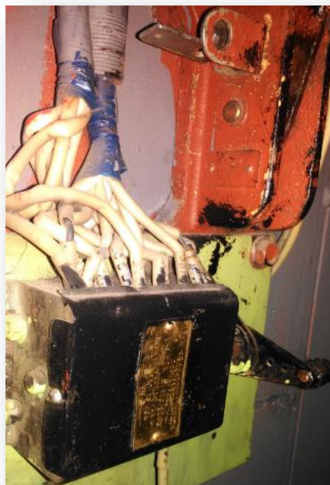
Многочисленные кабельные связи =220В. Отсутствие действующей документации
