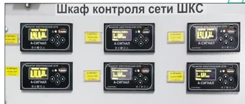
Шкаф (настенное исполнение)
